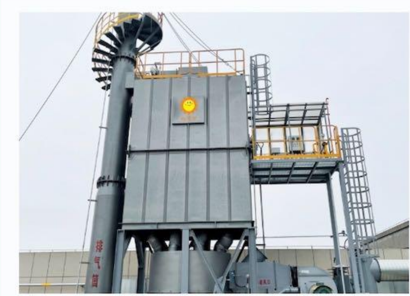
上海某零部件有限公司 配置:15000m 3 /h
