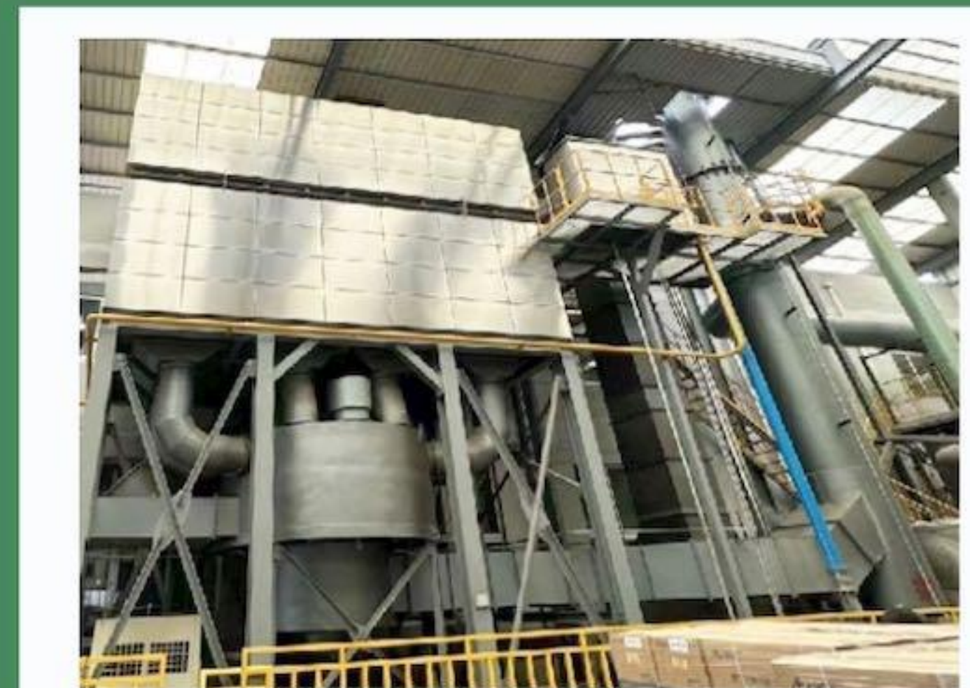
青岛某手套有限公司 配置:5000m 3 /h+导热油换热
