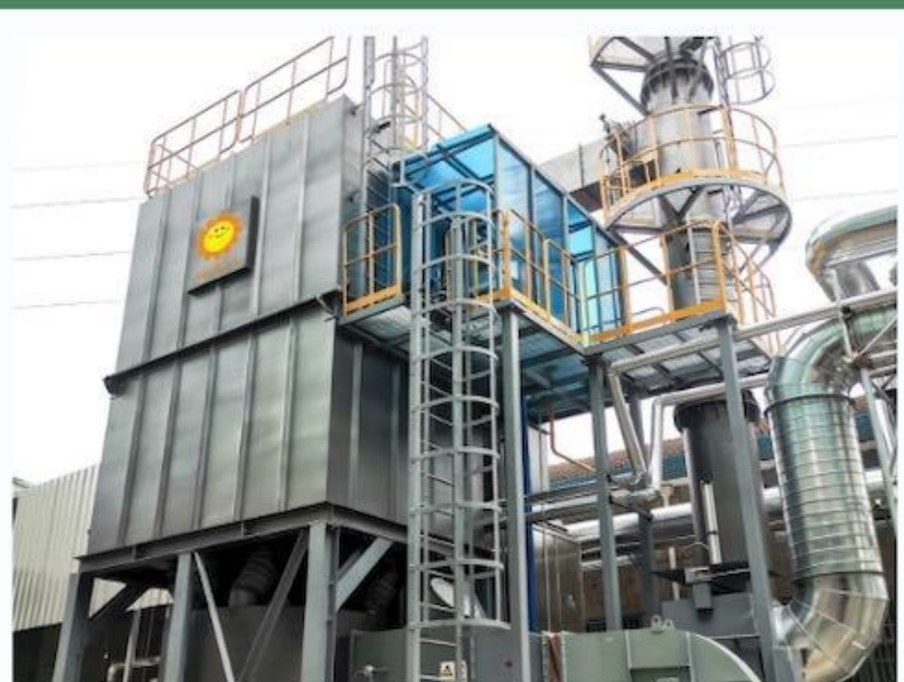
常州某材料有限公司 配置:20000m 3 /h
