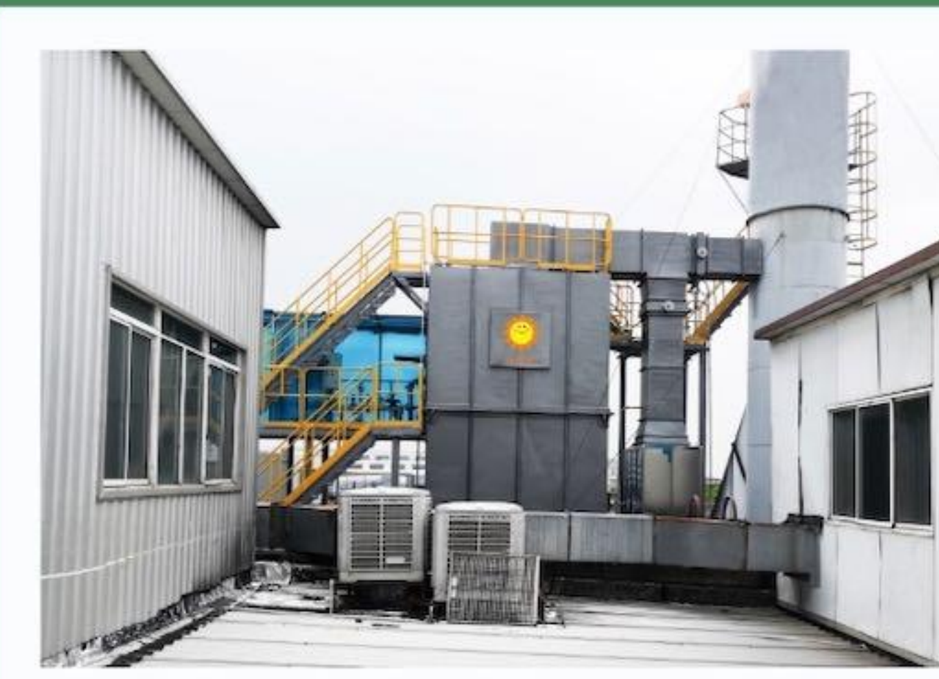
重庆某包装有限公司 配置:30000m 3 /h+热水换热
